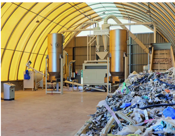
Fossilisateur construit dans l'usine pilote à Chalonnnes sur Loire
